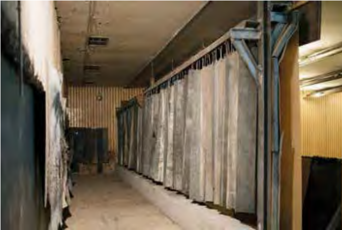
Espacio posterior a la pared de la Sala de tiro con varias balas en el suelo.
